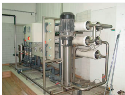
Slika 5. Primjer postrojenja za desalinizaciju kapaciteta 6 – 660 m 3 /dan [13]
