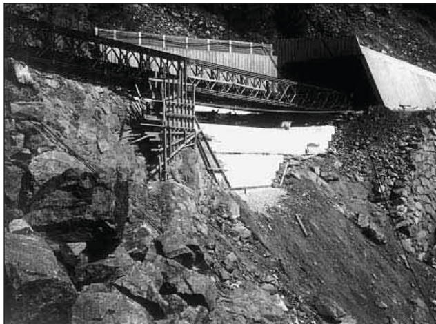
Slika 8. Primjer sanacija cestovnog nasipa na planinskoj cesti uporabom EPS geopjene (Sougdahl, Norveška), [4]
