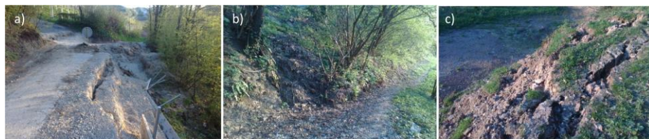
Slika 1. Klizište Gradišće neposredno nakon aktivacije: a) oštećenja na lokalnoj prometnici; b) naguravanje pokrenute klizne mase na put u središnjem dijelu klizišta; c) sekundarne vlačne i posmične pukotine u nožici klizišta (fotografije D. Udovič).
